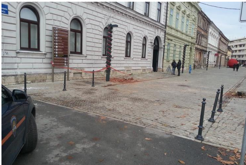
Oštećenja zgrada nakon potresa 28. prosinca 2020.g.
