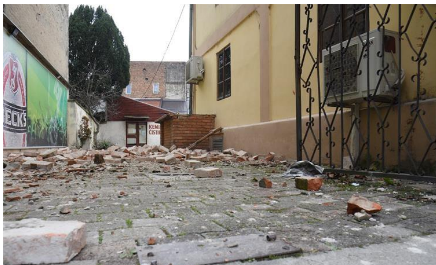
Oštećenja zgrada nakon potresa 28. prosinca 2020.g.
